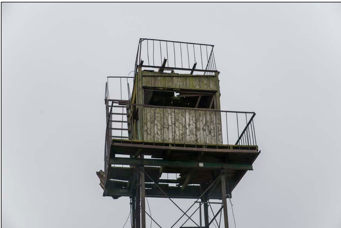
Foto 11 (076). Haldi tehnilise vaatluse post. Vaadetorni platvormi põrand on täiesti mäda. Foto Mart Mõniste 26.10.2014.
