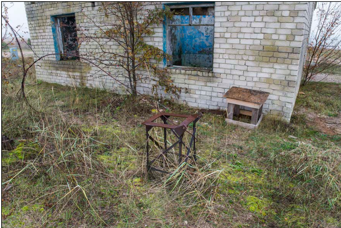
Foto 12 (078). Haldi tehnilise vaatluse post. Raadiomasti alus. Foto Mart Mõniste 26.10.2014.
